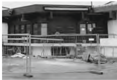
Der Kursaal wurde grundlegend saniert, im Frühjahr geht der letzte Bauabschnitt zu Ende.
