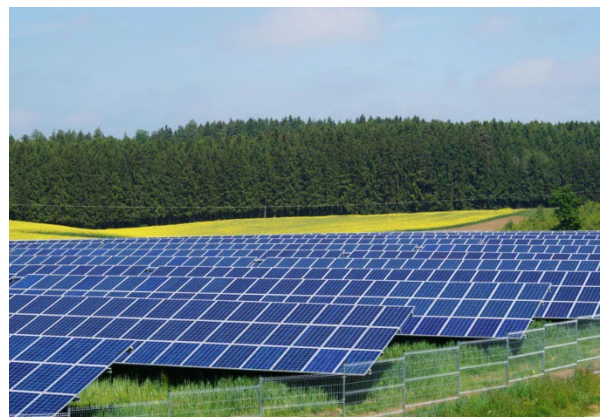
Freiflächen-PV-Anlage vor Waldkulisse
