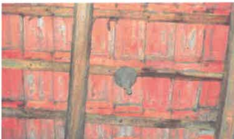
Dachboden mit Wespennest
