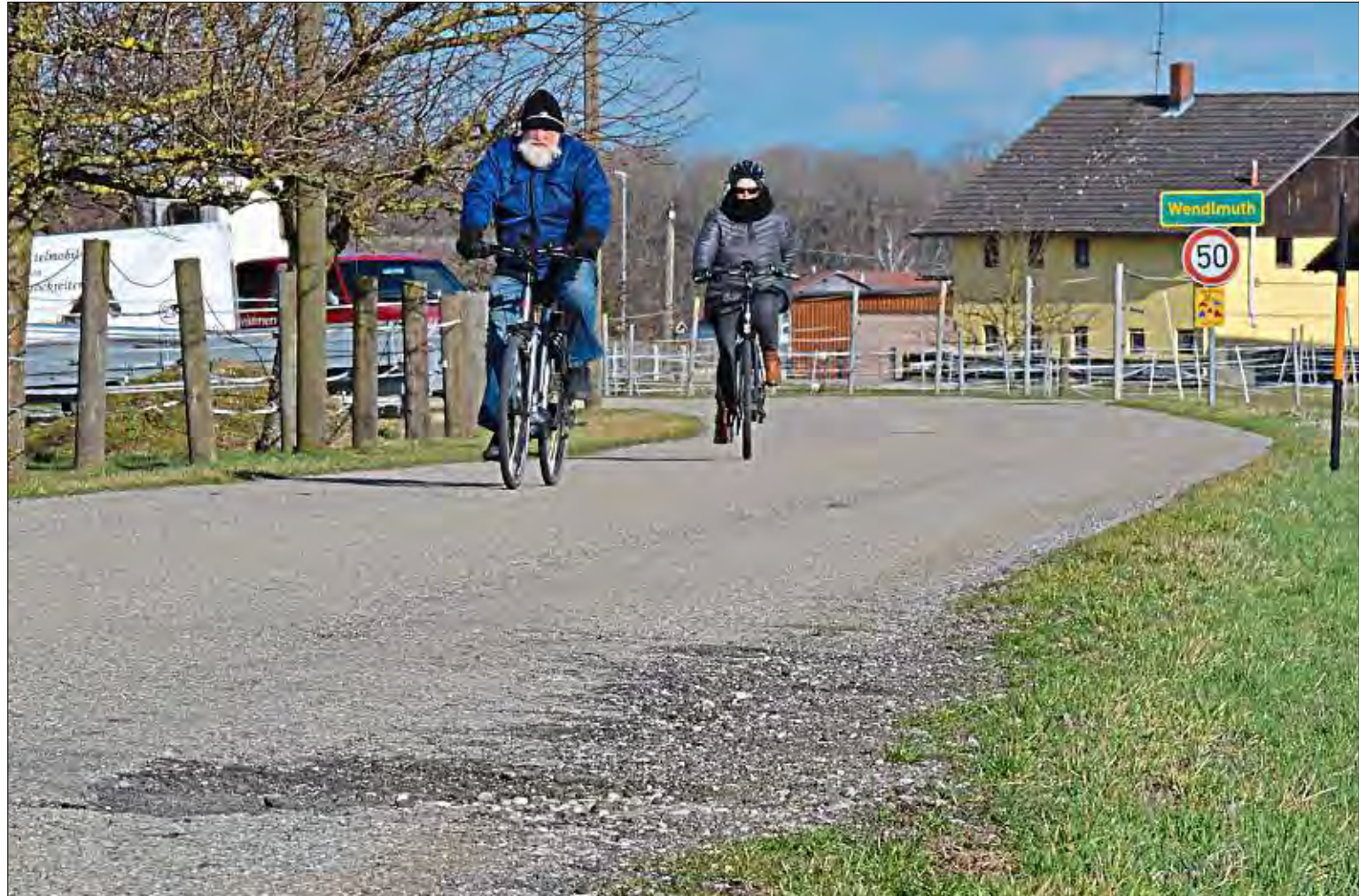
Schlaglöcher & Co.: Saniert werden soll heuer die Straße bei Wendlmuth bis zur Gemeindegrenze Malching – eingeplant werden dafür 66 000 Euro. – Fotos: Jörg Schlegel
